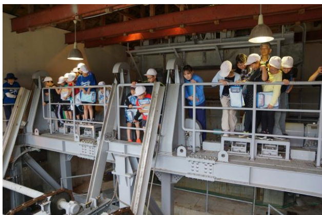
【青ブナ取水口除塵機】
