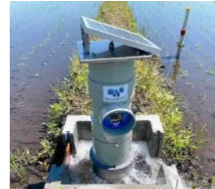
水管理の遠隔監視・操作
