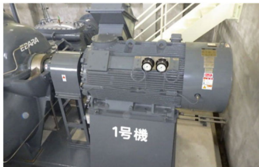
高効率電動機への更新による 省エネルギー化
