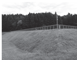
▲維持管理が省力化された貯水施設
