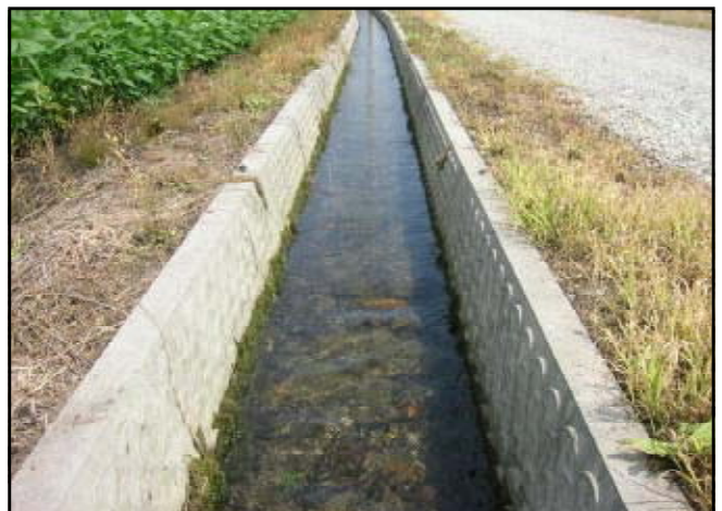
生態系に考慮した用水路
